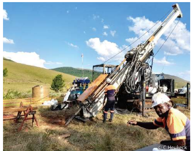
図1：バーバートン地域西部の農場の中の掘削の様子。農道しかない中をトラックが移動するのは至難の技でした。
